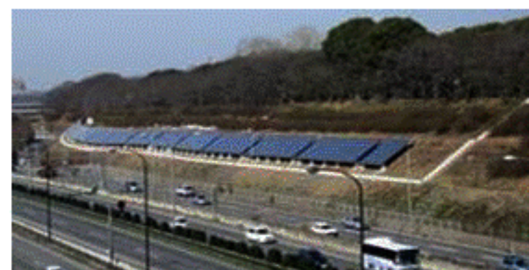
のり面を活用した太陽光発電
